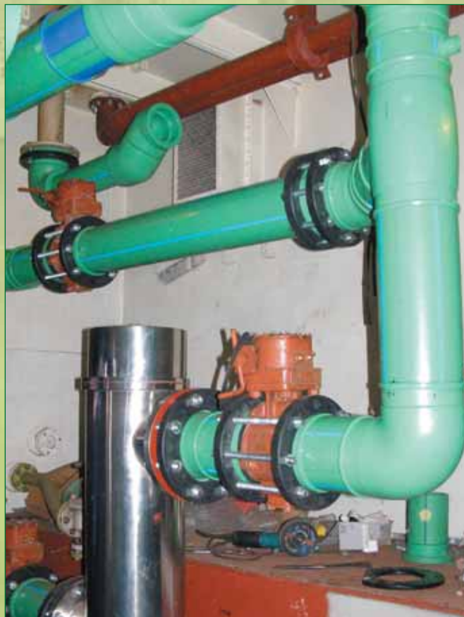
Пластмассовые трубы установки УФ-обеззараживания забортной воды, заказ № 616
