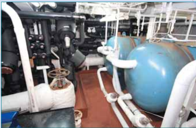
Ресиверы холодильных машин
