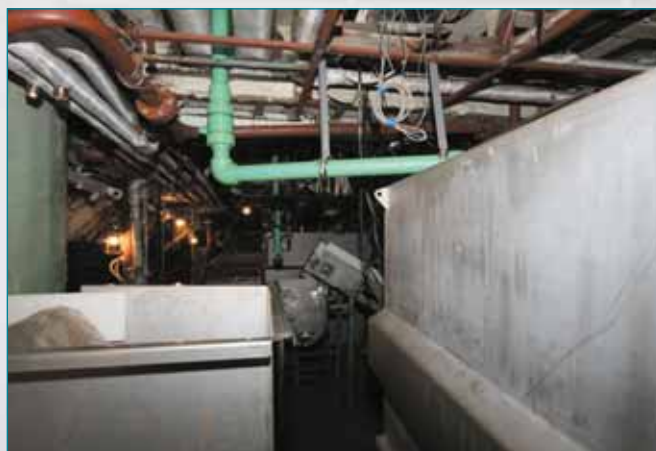
В рыбообрабатывающем цехе установлены пластиковые трубопроводы
